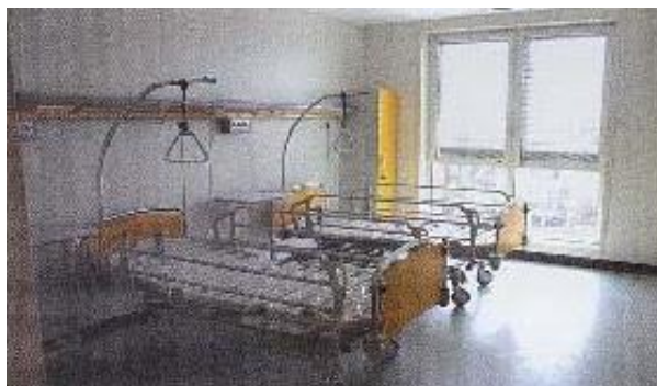
CHAMBRES DES PATIENTS AVEC UN SYSTÈME D'INDUCTION A POUTRES FROIDES
