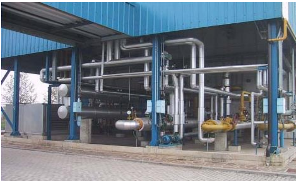
CENTRALE THERMIQUE AVEC CHAUDIÈRE À
