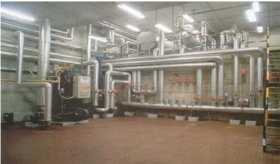
CENTRALE TERMICA CON CALDAIE A VAPORE
